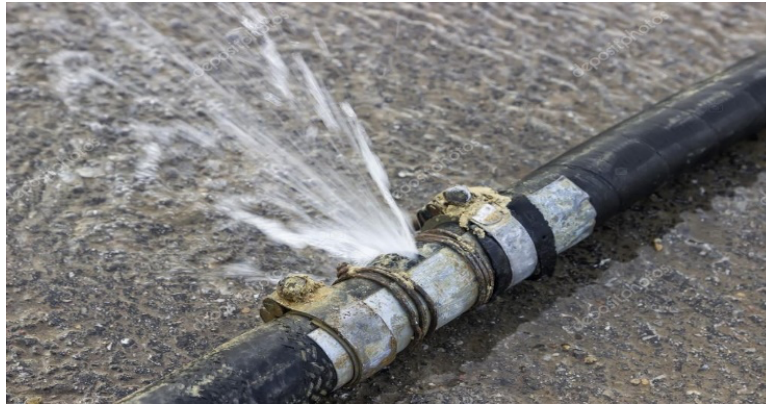
Figura 1. Tubería dañada por exposición ambiental.
