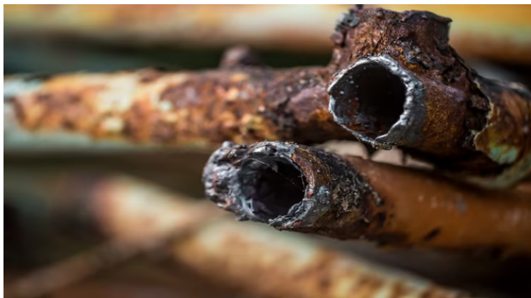
Figura 2. Sección transversal de una tubería con acumulación de sarro.
